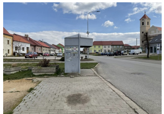
Zchátralá autobusová zastávka v centru obce
